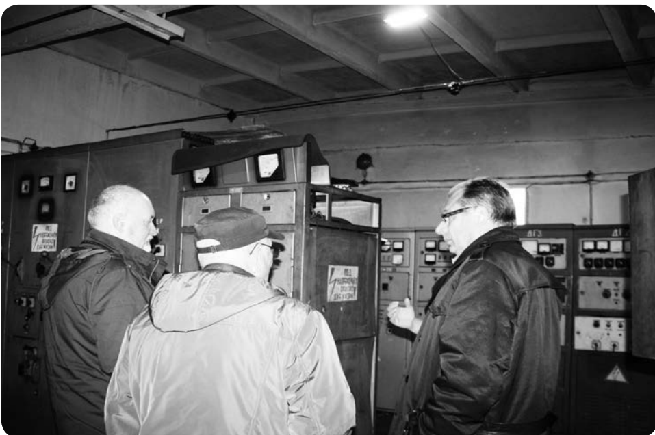
Обсуждение работы ДЭС в Амдерме
